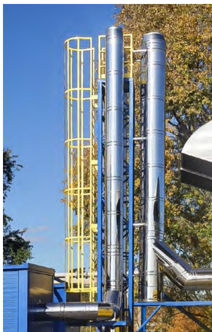
Mała elektrociepłownia, Racibórz
