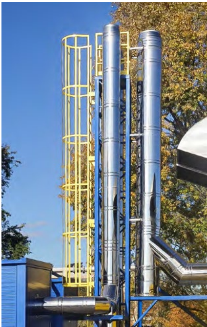
Kleines Heizkraftwerk, Racibórz . Polen
