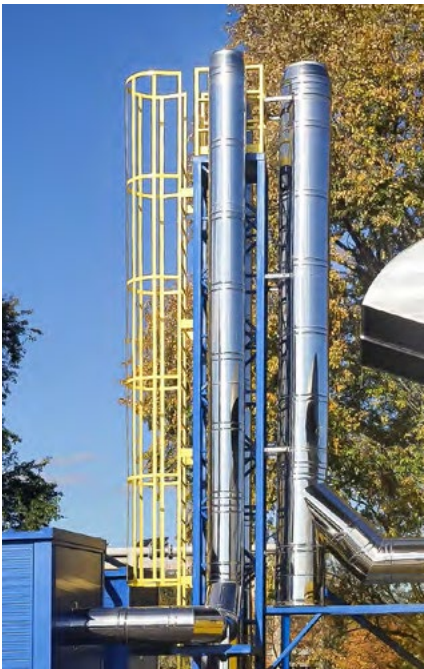
Kleines Heizkraftwerk, Racibórz . Polen
